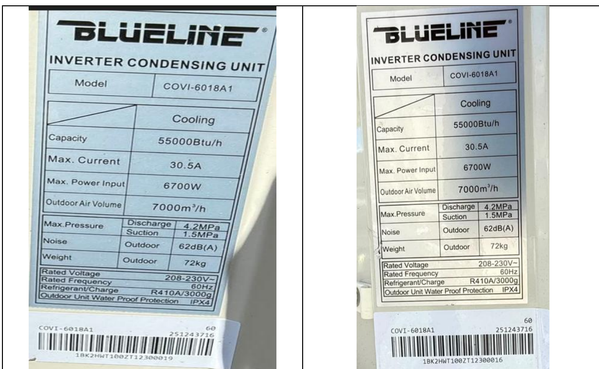
“Unidades Condensadoras” Suministrados e Instalados (S/N 1BK2HWT100ZT12300016, 1BK2HWT100ZT12300019)
