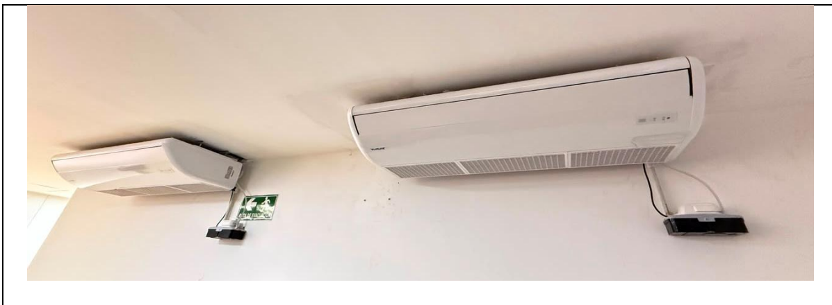
“Cassettes o Unidades Manejadoras” Suministrados e Instalados
