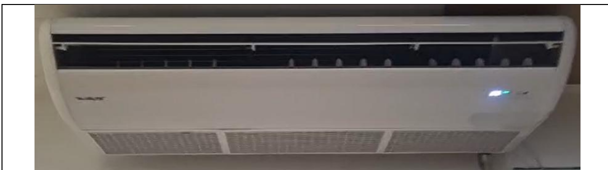
“Cassettes o Unidades Manejadoras” Suministrados e Instalados
